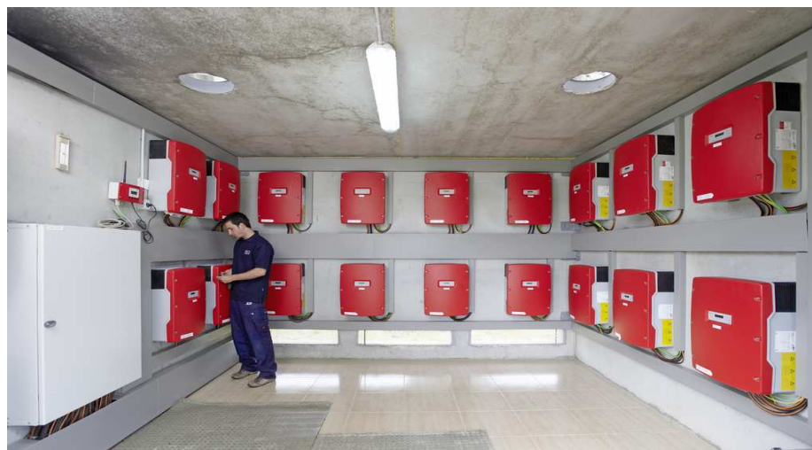
Figura 17 - Sala de inversores de um sistema fotovoltaico
