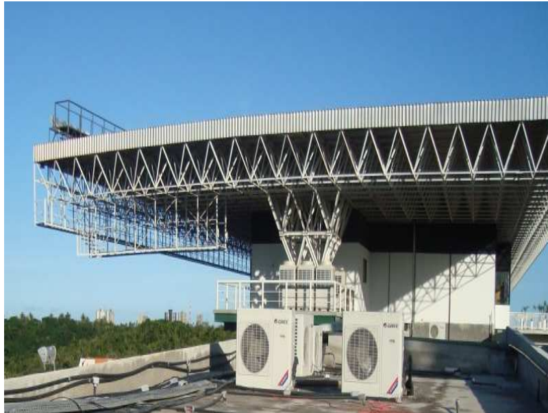
Figura 2 - Exemplo de cobertura metálica (seções principais, indicadas com os números 3 e 4 na Figura 1)
