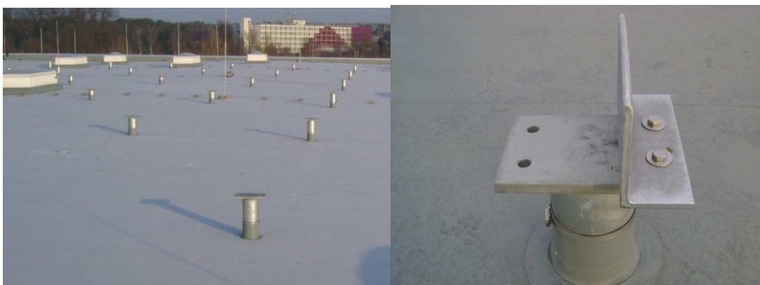
Figura 9 - Pilaretes metálicos de suporte para as estruturas metálicas do sistema fotovoltaico
