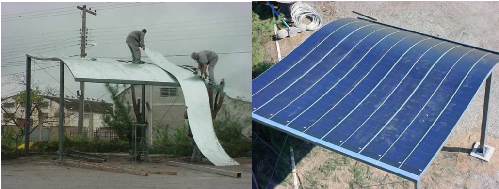
Figura 6 -Módulos fotovoltaicos integrados sobre estrutura metálica
