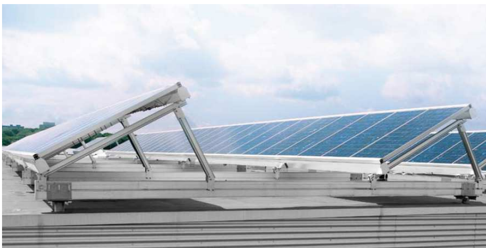
Figura 8 - Estrutura metálica para sistemas fotovoltaicos utilizando perfilados de alumínio
